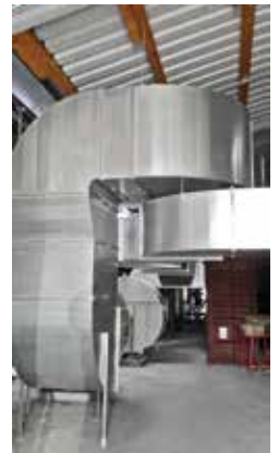
Lüftungskanäle und Container als Mischkammer im Hintergrund
