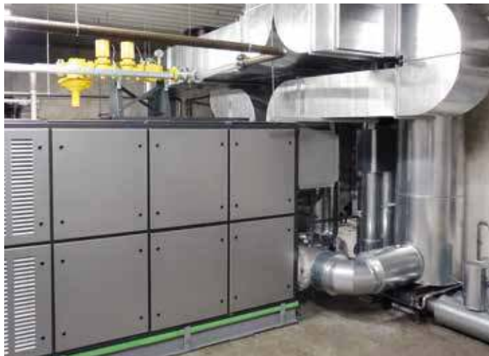
Abgastechnik und Entlüftungssystem
