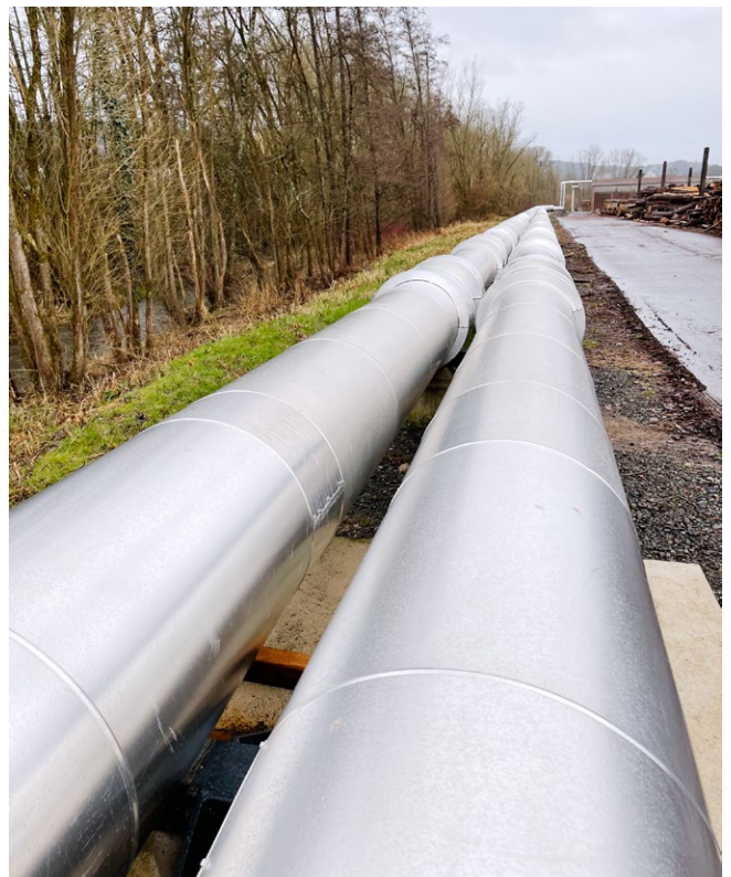
385 m Hochtemperatur-Fernwärmetrasse mit Vor- und Rücklauf versorgt die Dampferzeuger in der Produktion.
