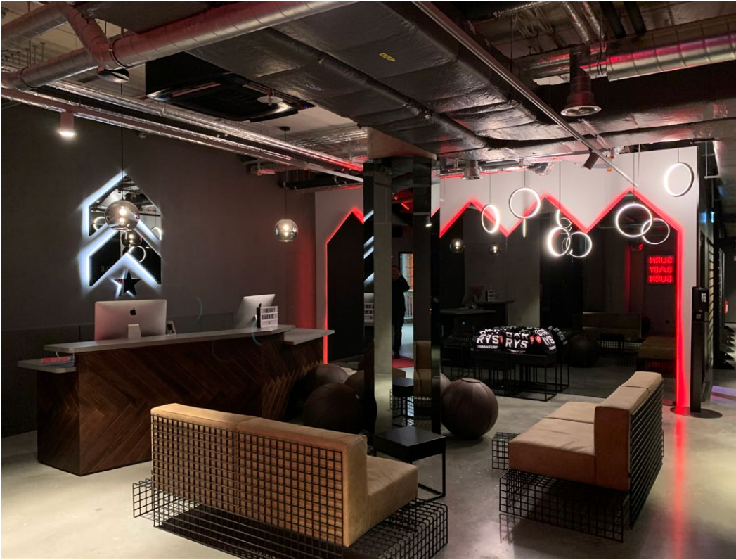
Die Lüftungstechnik wird zum Designelement im Industrial Look. Die Lüftungskanäle wurden nach den Vorgaben des Kunden lackiert.
